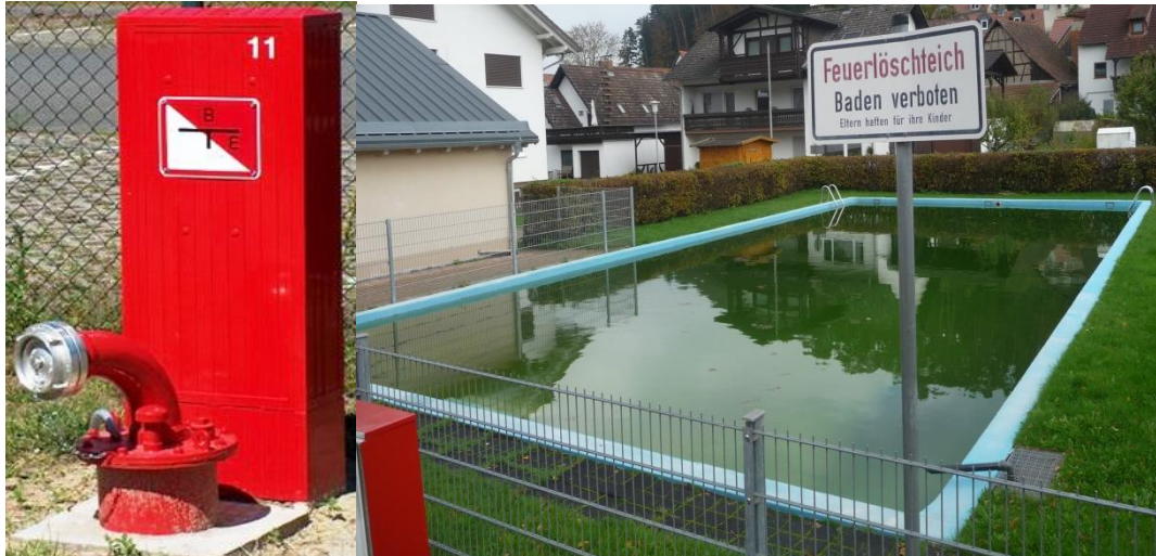
Abbildung 3–1: Links: Sauganschluss zur Wasserentnahmen aus einem Löschbrunnen. Rechts: eingezäunter Löschwasserteich bzw. Löschwasserbecken im Odenwald. Aufnahmen: Luis Lohde GmbH; IWW.
